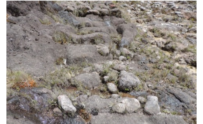
Figura. Evidencia de la técnica de construcción del camino a través de la excavación de pequeñas cunetas en el afloramiento rocoso para la cimentación del empedrado
