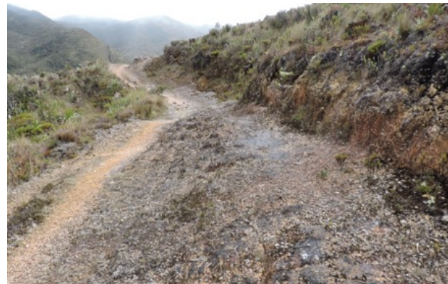
Camino de 4 metros de ancho de roca natural y corte de talud lateral
